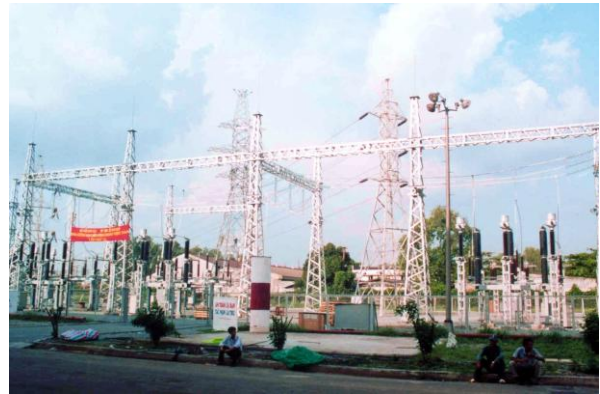
Hình 5-2. TRẠM BIẾN ÁP
